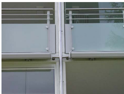
drainage par tuyau de descente
