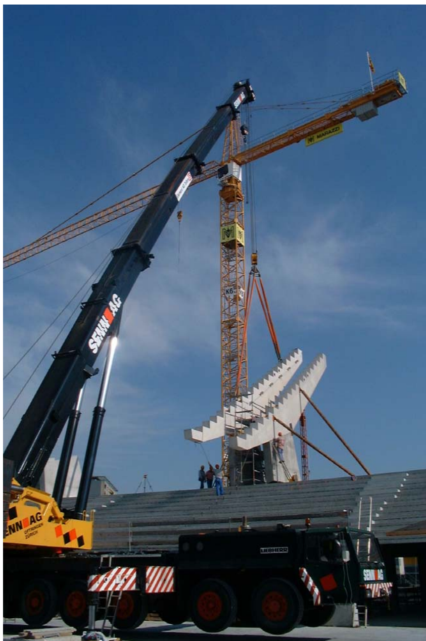
La paire de crémaillères est posée au millimètre près sur la tranche des colonnes coulées sur place
