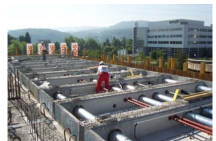
Installations techniques du bâtiment montées finies dans les éléments en auge avant la pose des plafonds filigranes et du béton de parement
