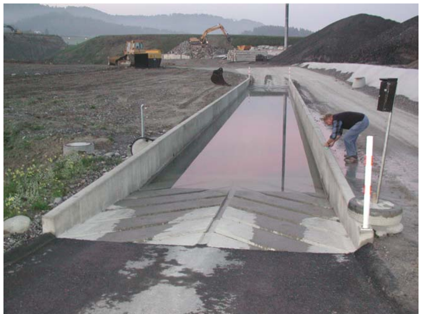
Poste de lavage en état de marche
