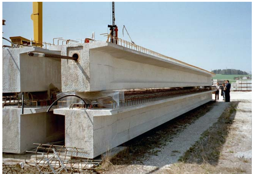
Poutres sur la place de stockage. Le câble de précontrainte incorporé est bien visible.
